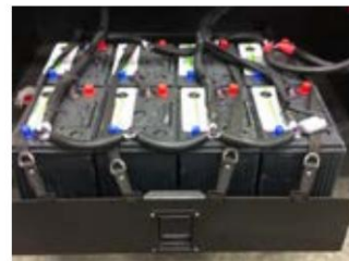
Exemple de banque de batterie AMG House
