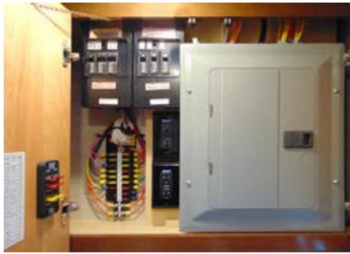
Exemple de panneau de fusibles à poussoir diesel
