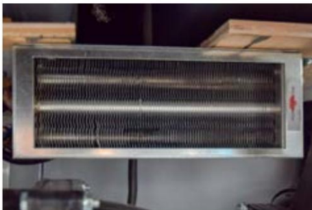
Échangeur de chaleur du sous-sol Oasis
