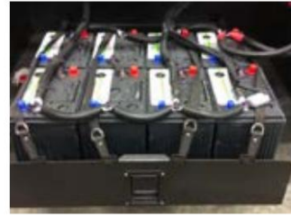
Exemple de banque de batterie AMG House
