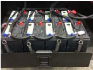
Exemple de banque de batterie AMG House
