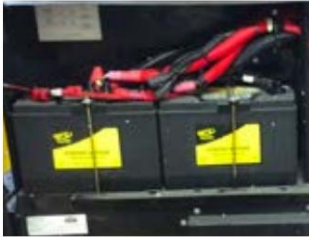
Exemple de groupe de batteries de châssis
