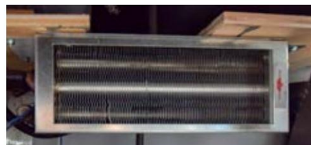
Échangeur de chaleur du sous-sol Oasis
