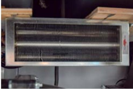
Échangeur de chaleur du sous-sol Oasis
